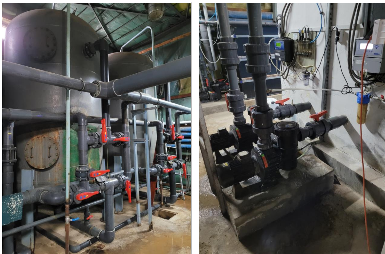
Istniejące filtry ciśnieniowe i pompy obiegowe
